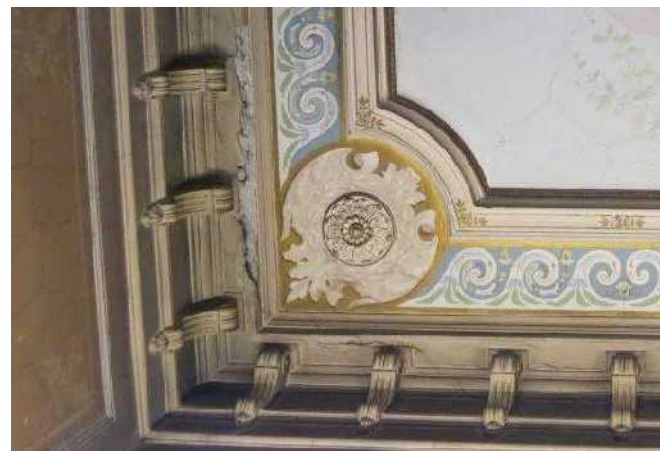
Hiushalkeamia ja kattolistan lohkeama (kattopinta K8). MH
