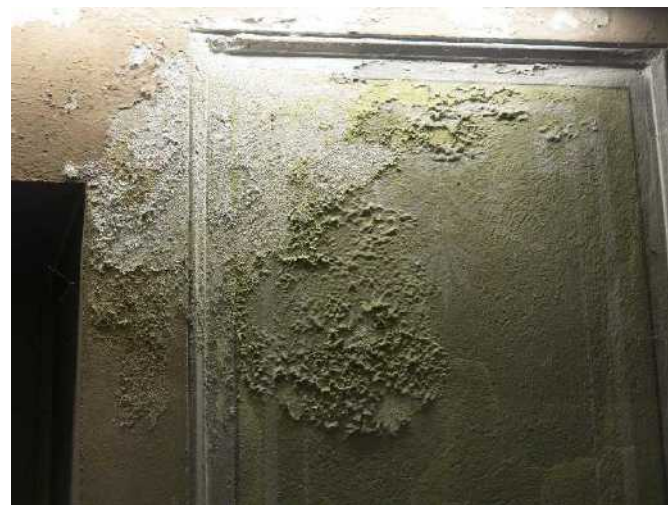
Vesivaurioita ensimmäisellä kerrostasanteella (seinäpinta S8). RT
