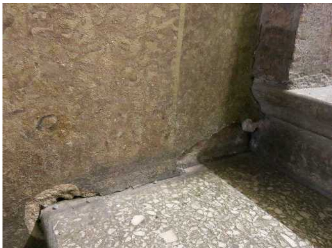
Rappauspinnan vaurioita porraskelman ja seinän yhtymäkohdassa (seinäpinta S6). MH
