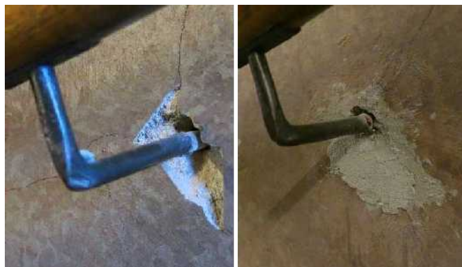
Löystynyt ja kömpelösti korjattu käsijohteen kiinnitys. MH
