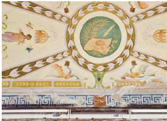
Kosteuden aiheuttamia vaurioita ensimmäisen porrastasanteen katon (kattopinta K3) maalauspinnaassa. RT
