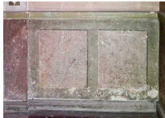
Käytön aiheuttamaa kulumaa seinäpinnan alaosassa sekä lohkeamia kerroslistassa (seinäpinta S2). RT
