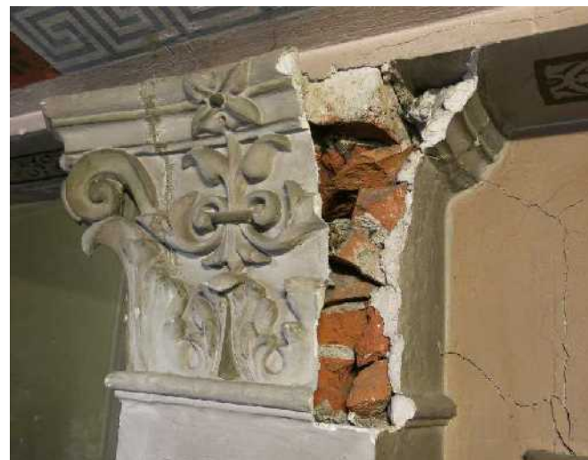
Ilmeisesti perustan liikkumisesta seurannut rikkoutunut kapiteeli ja seinän hiushalkeamia (seinäpinta S3). MH
