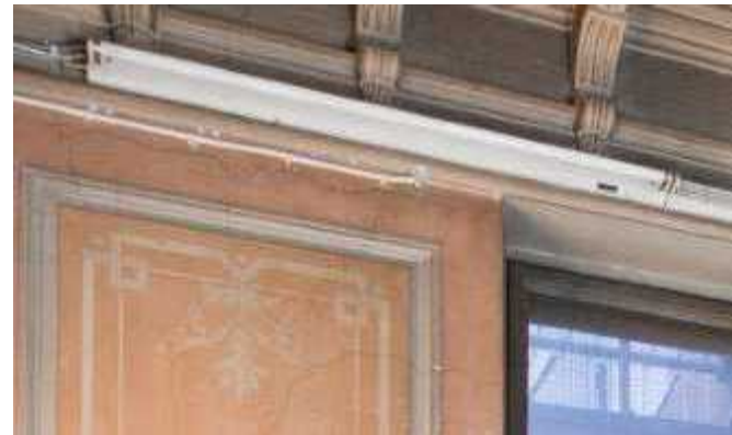
Porrashuoneen valaisimina on yksinkertaiset seinille kiinnitetyt loisteputkivalaisimet. Kaikki sähköt on vedetty pinta-asennuksina. RT
