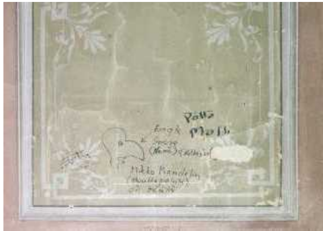
Tussisuttuja ja seinäpinnan krakeloitumista ensimmäisen kerroksen eteistilan seinäpinnalla (seinäpinta S2). RT
