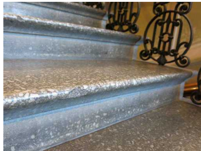
Porraskelman etureunan lohkeama (lattiapinta L10). MH
