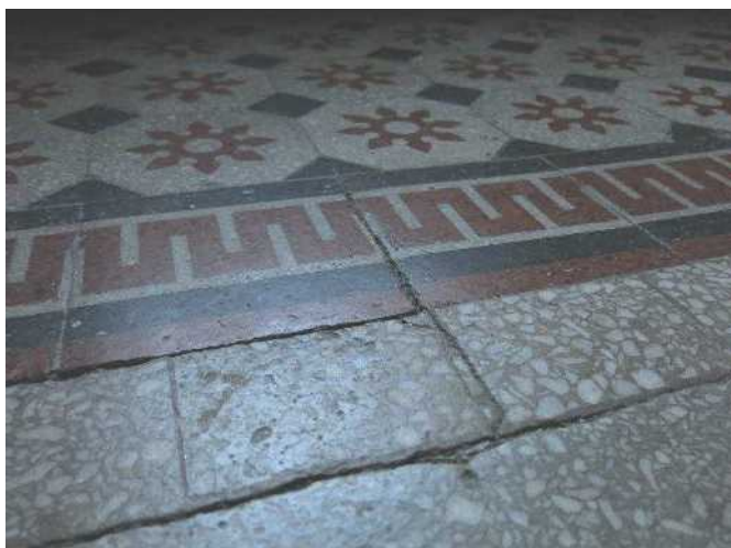
Kerrostasanteen lattiapinnan halkeama (lattiapinta L9)
